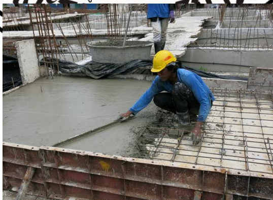
รูปที่ 1.10 ภาพแสดงลักษณะของพื้นคอนกรีตแบบพื้นหล่อในที่
